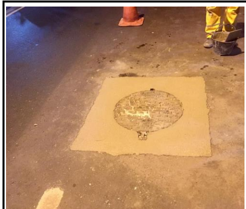
RUA TIROL LEVANTAMENTO DE TAMPÃO
