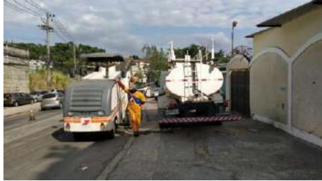
SERVIÇO: EQUIP DE APOIO (TANQUE)
