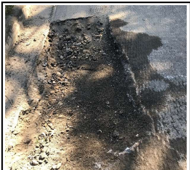
ESTRADA DO RIO GRANDE REMENDO PROFUNDO
